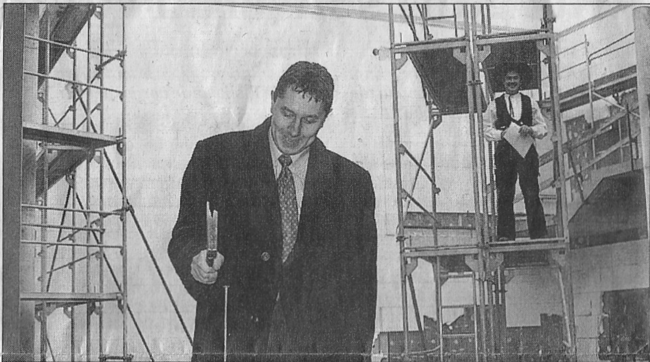
Akteure beim gestrigen Richtfest an der neuen Brandiser Mittelschule: Bürgermeister Andreas Dietze und Zimmermann Matthias Tschinkl. Foto: Andreas Röse
